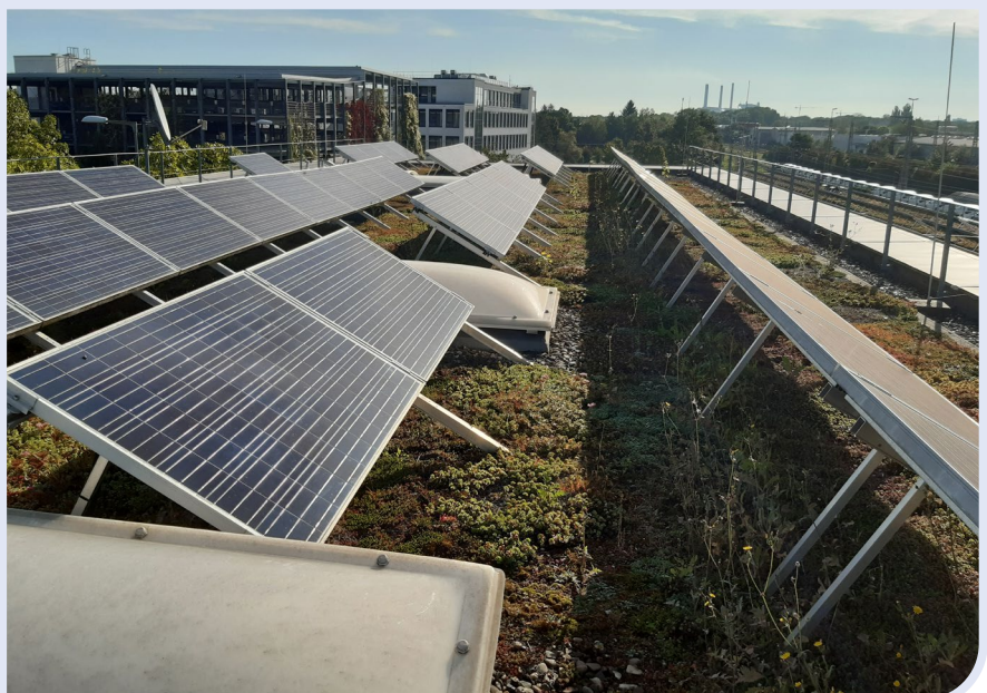
Abb. 5: Städtisches Gebäude in München mit einer Kombination von Dachbegrünung und PV-Modulen.
